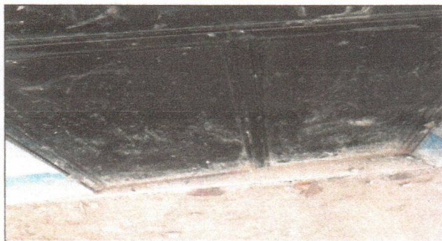
Foto 5: Se ve la necesidad de reforzar la puerta.
