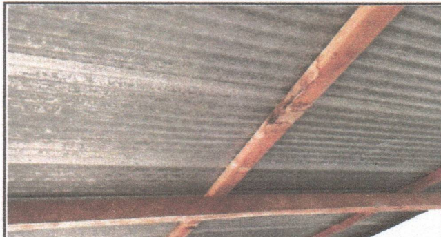
Foto 2: Se observa la necesidad de sustituir la estructura de madera por estructura metálica.
