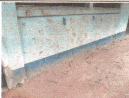
Foto 1: Se observa la necesidad de pintar las paredes tanto interior como exterior del establecimiento educativo
