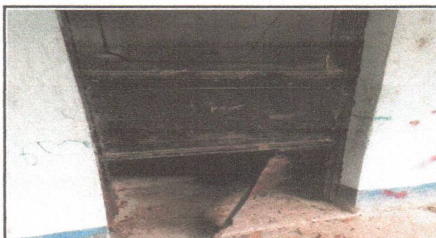
Foto 4: Se ve la necesidad de sustituir la puerta.
